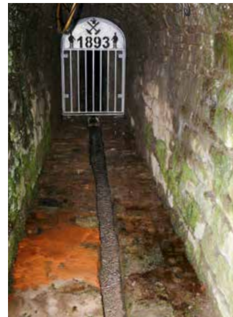
Abb. 28: Stollenmundlöcher im Ruhr-Revier (links: Franziska-Erbstollen [Witten]; rechts: Vereinigte Pflingstblume [Bochum]; Fotos: Forschungszentrum Nachbergbau).
