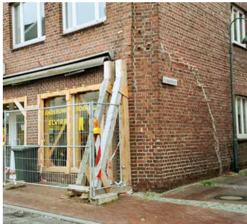
Abb. 38: Gebäudeschäden infolge des Grubenwasseranstiegs im Erkelenzer Steinkohlenrevier (Fotos: Volker Baglikow).
